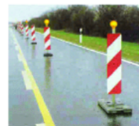
Luces amarillas fijas o intermitentes
